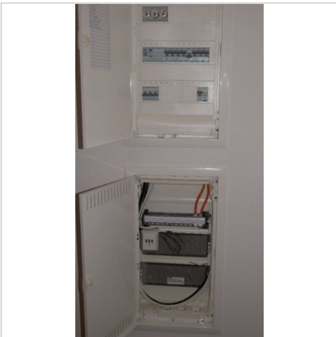
Elektrik und Kommunikation
